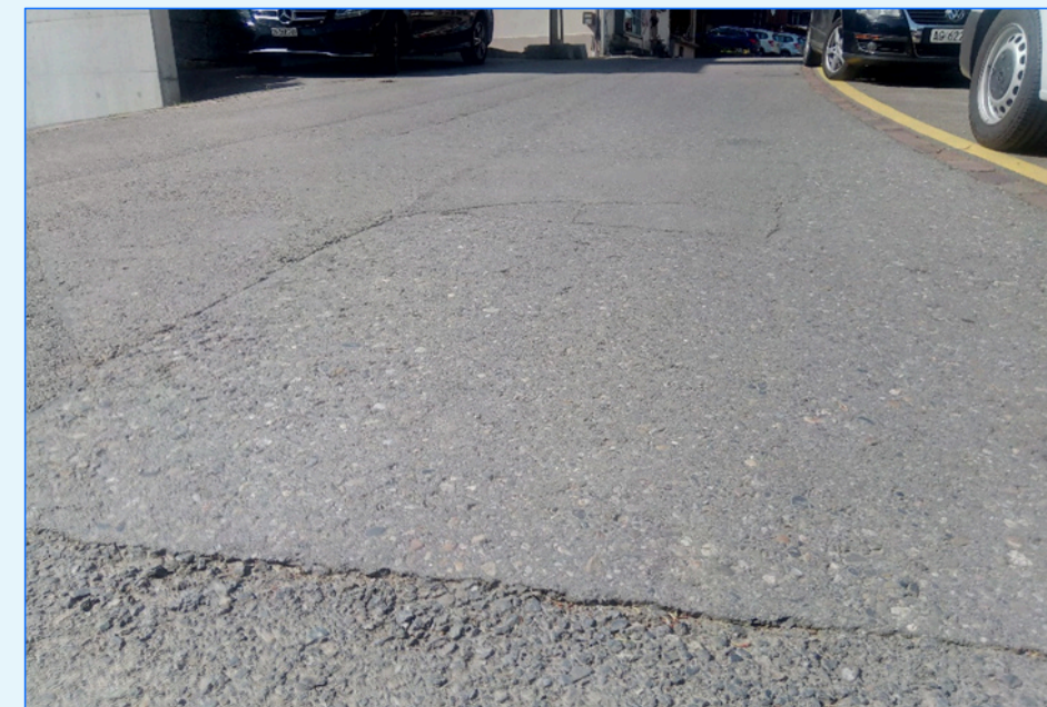
Schadhafter Belag in der Schulhausstrasse
